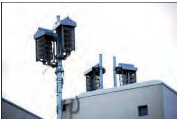
同報系防災行政無線の整備例（河北町）
