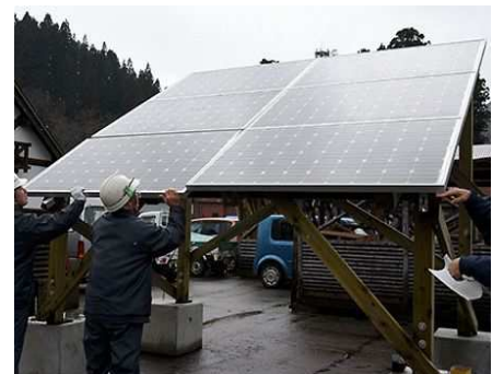
太陽光発電パネル木製架台（金山町）
