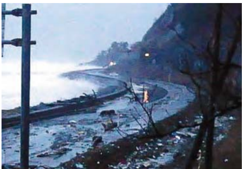
国道 7 号越波による被害状況(鶴岡市早田) 〔平成 24 年 4 月 4 日 10 時間 35 分の全面通行止め〕
