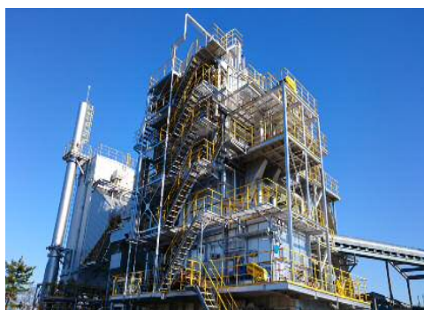
《庄内地域における木質バイオマス発電所（山形県）》
