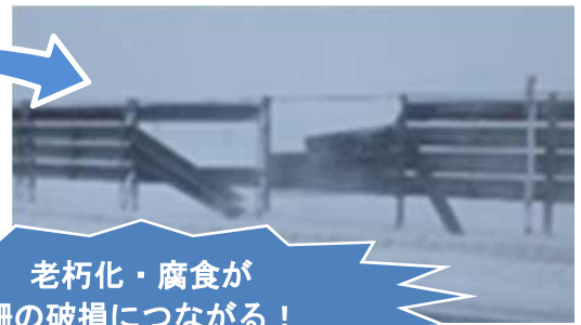
◎防雪柵破損状況写真（30年以上経過）
