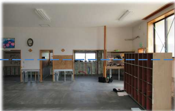
破線（青）で図示している地点まで浸水
