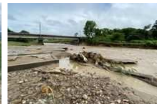
頭首工の崩壊（南陽市）
