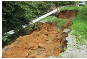
農道の崩壊（酒田市）
