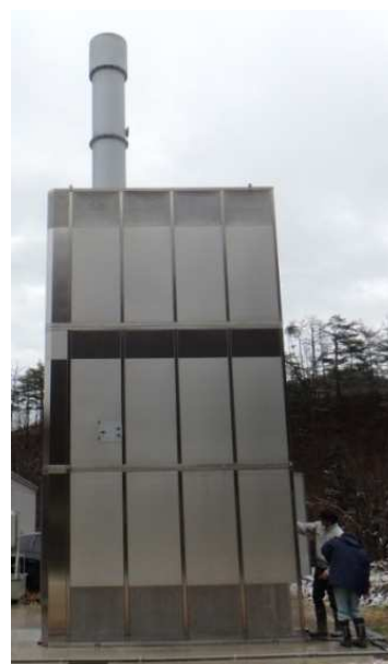
廃棄物焼却炉
