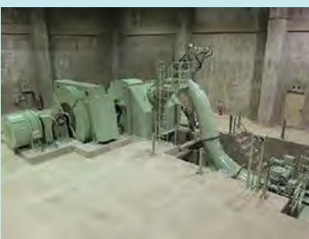
最上川中流小水力南館発電所
