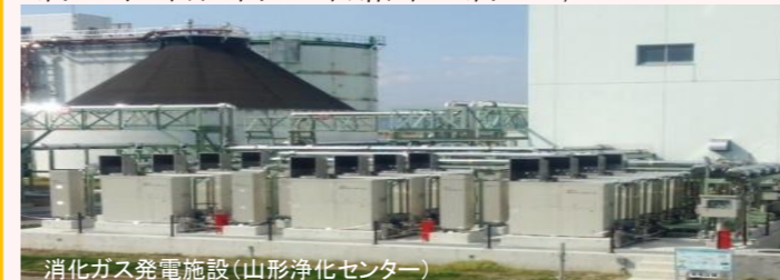
消化ガス発電施設(山形浄化センター)
