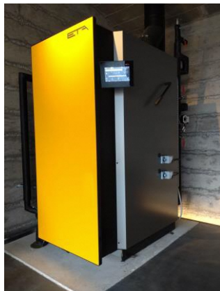
バイオマスボイラー
