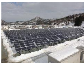
県営太陽光発電所
