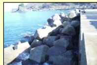
消波ブロックの沈下
