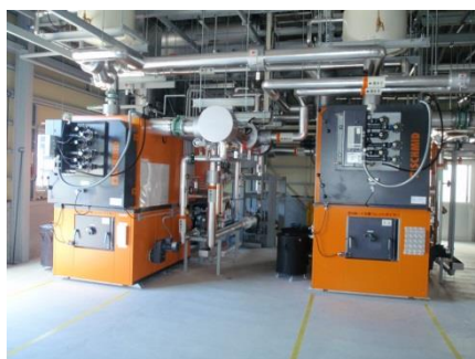
ペレットボイラー
