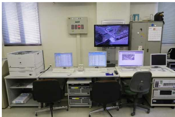
現在の ダムコントロール設備
