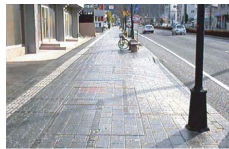
段差の無い部分が設けられた無散水の消雪歩道です。冬期間も安全、快適に歩くことができます。
