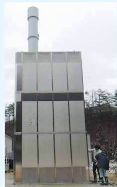
廃棄物焼却炉
