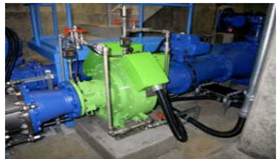
平田浄水場 小水力発電設備
