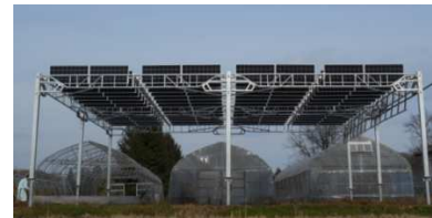
営農型太陽光発電設備
