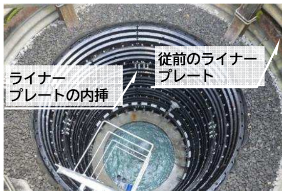
集水井（しゅうすいせい） ※地すべりを抑制するため 地下水を集水する井戸
