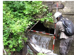
堤体底部の抜け
