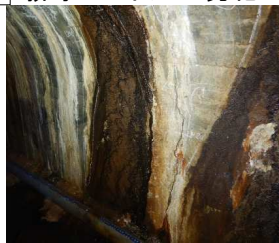
排水トンネルの劣化
