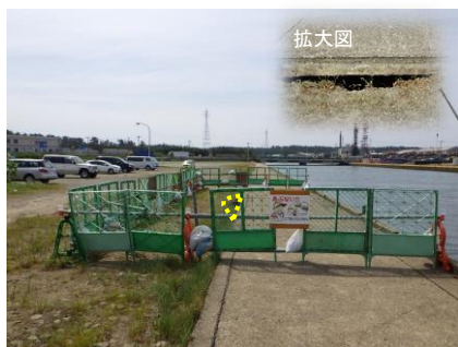
古湊護岸（H30年度発生）
