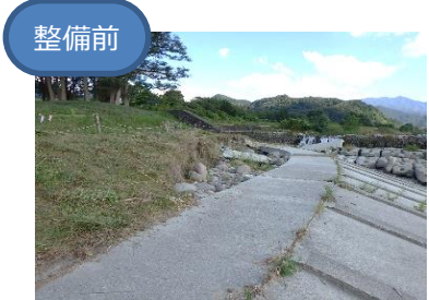
➢ 護岸が洗堀され治水安全度が低下している状況
