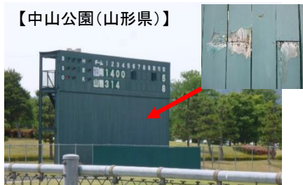
▲老朽化により修繕が必要となったスコアボード
