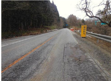
▲路盤が損傷した舗装の例
