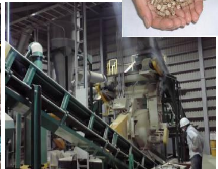
バイオマス燃料加工工場
