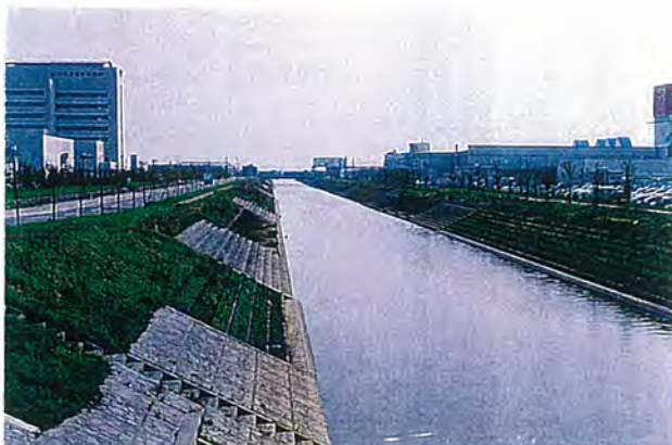
低水部に階段護岸を整備し、親水性を向上させている。ただし、その幅や設置位置、間隔の設定には十分な検討が必要である。
