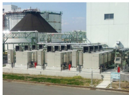
山形浄化センター
