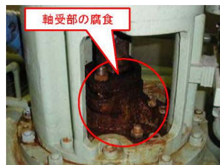
ポンプ設備の腐食
