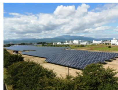
山形浄化センター
