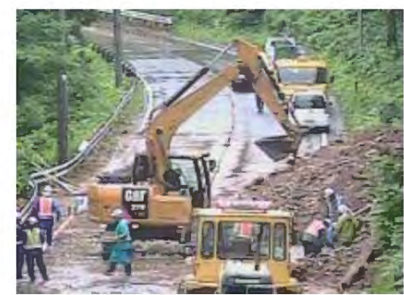
▲国道47号への土砂流入 (最上町H30.8)
