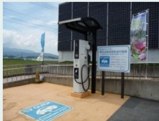
▼EV充電器の設置例
