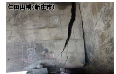
図 主桁コンクリート損傷状況
