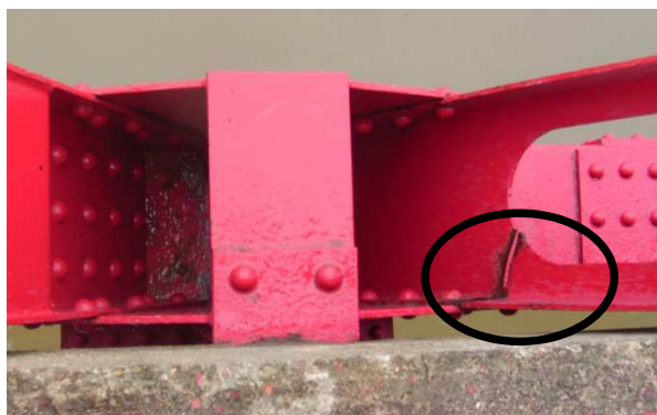
図-1.7 風による鋼部材の疲労損傷の事例（トラス斜材の破断）
