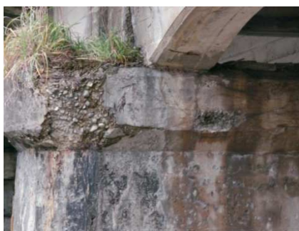
図-1.3 凍害による損傷事例
