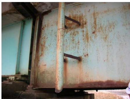
図-1.2 伸縮装置からの漏水による桁端部の腐食事例
