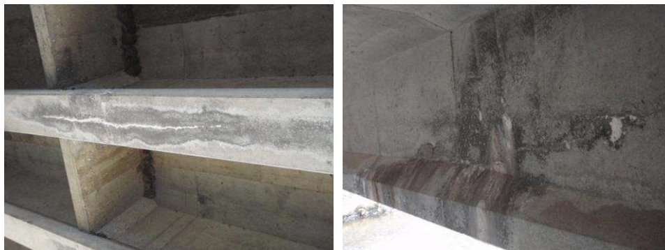
図-1.5 PC グラウトの充填不足による損傷事例
