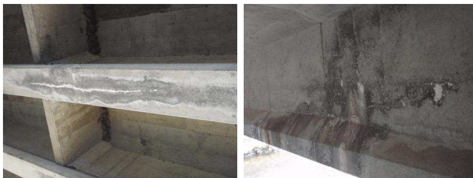
図-1.5 PC グラウトの充填不足による損傷事例
