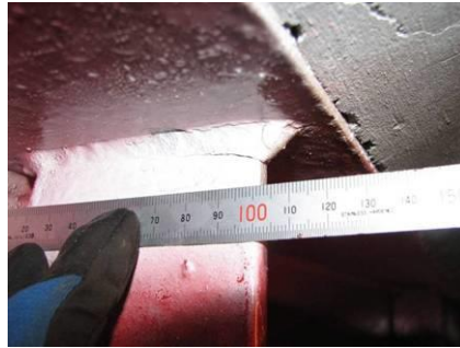
垂直補剛材と上フランジ溶接部の亀裂
