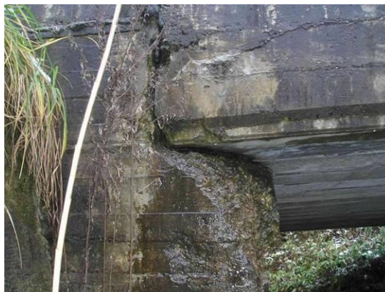
橋座部の凍害によるスレーキング
