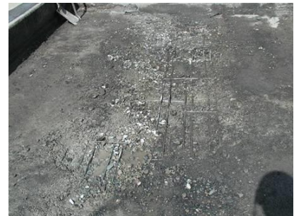
防水層未設置箇所の床版上面土砂化
