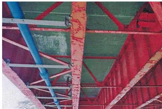
碎石によるマウンドアップ歩道箇所における床版下面の遊離石灰（歩道下に集中）
