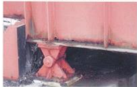
桁端部の腐食による下フランジとウェブの剥離（伸縮装置からの漏水）
