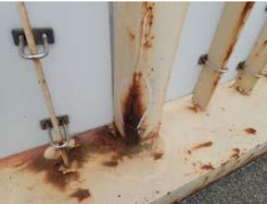
写真 2-3 高欄 腐食、防食機能の劣化
