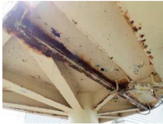
写真 2-2 床版(デッキプレート) 腐食
