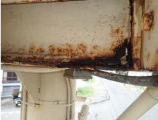
写真 2-1 主桁 腐食、防食機能の劣化
