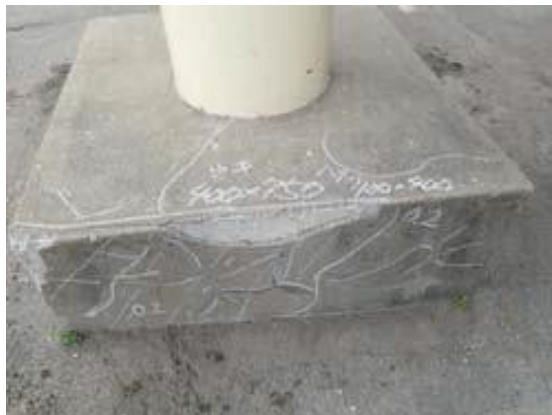
写真 2-4 橋脚フーチングのひびわれ、剥離
