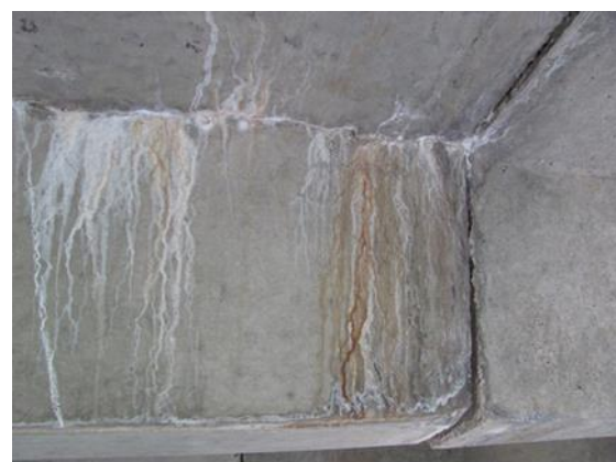
写真 2-4 シェッド横梁 遊離石灰
