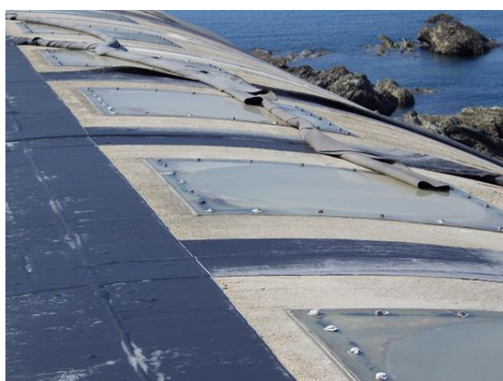
写真 2-6 シェルター外面 シール材の剥離
