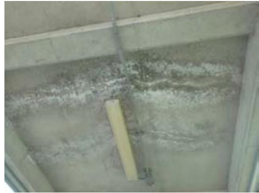
写真 2-10 上屋頂版 ひびわれ、遊離石灰
