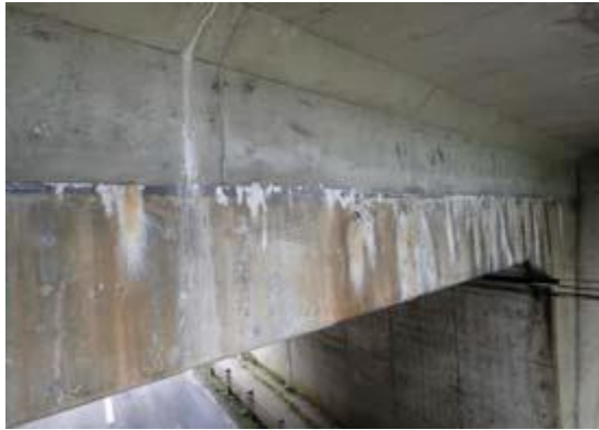
写真 2-9 大型カルバート頂版 ひびわれ、遊離石灰
