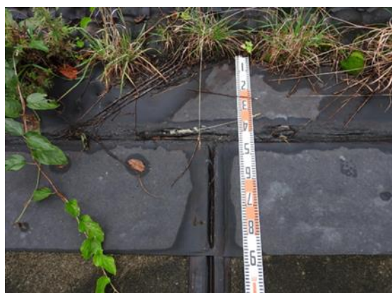
写真 2-3 シェッド頂版 防水シートの劣化
