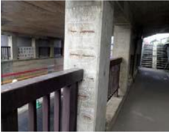
写真 2-7 大型カルバート側壁 剥離、鉄筋露出
