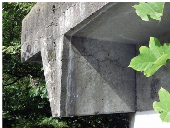
写真 2-2 シェッド横梁 ひびわれ、遊離石灰
