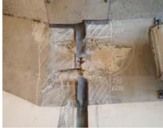
写真 2-8 大型カルバート頂版 剥離・鉄筋露出・うき
