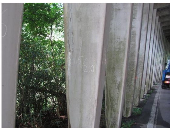
写真 2-1 シェッド柱 ひびわれ、遊離石灰
