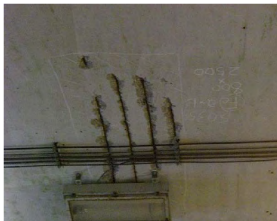
付写真-2.2 鋼材腐食の例
