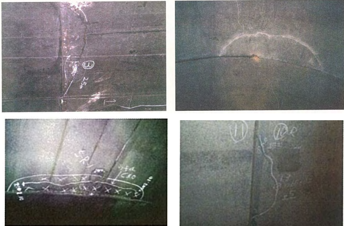
付写真-1.1 横断目地の天端付近に発生した半月状のひび割れの例
