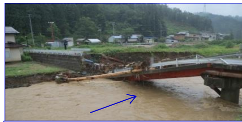
写-1 H26.7【吉野川 橋梁崩落】
