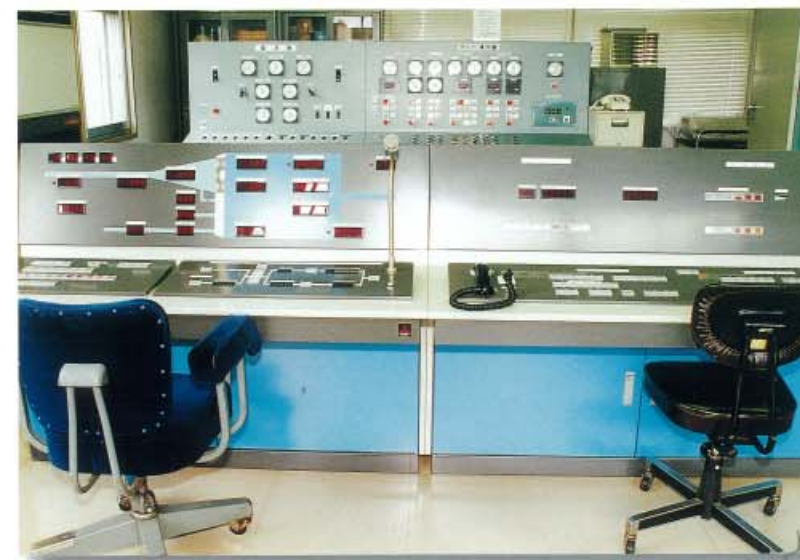
ダム諸量処理装置・テレメーター放流警報装置表示操作卓
