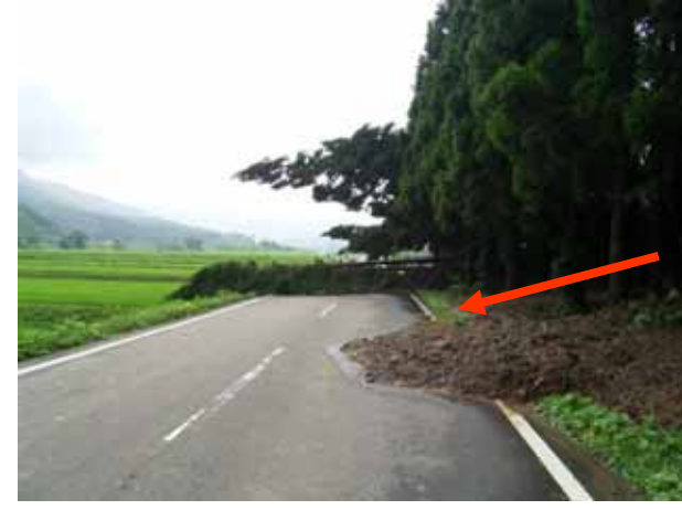
県道大中島・工藤沢線被災状況
