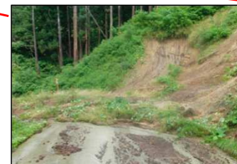
村山市 林道湯舟沢五十沢線 法面崩壊
