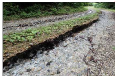
西川町 林道間沢川高旭線 路面洗堀
