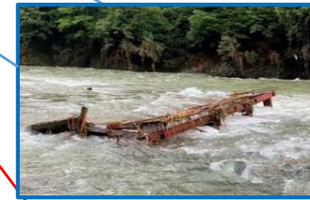
増水による築の土台損壊 (舟形町 7/30)
