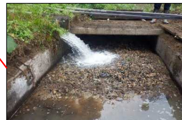
用水路の土砂堆積(長井市寺泉 7/26)
