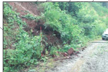
南陽市 中沢線 法面崩壊
