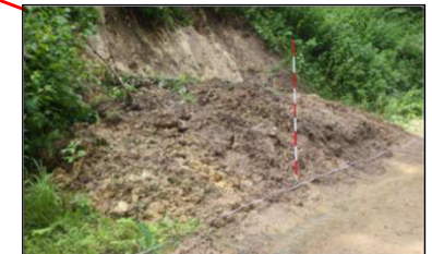
大江町 林道大瀬川葵左岸線 法面崩壊
