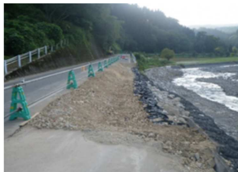
道路路肩の欠損。大型土のうによる盛土にて仮応急 (一)白滝宮宿線(朝日町立木)
