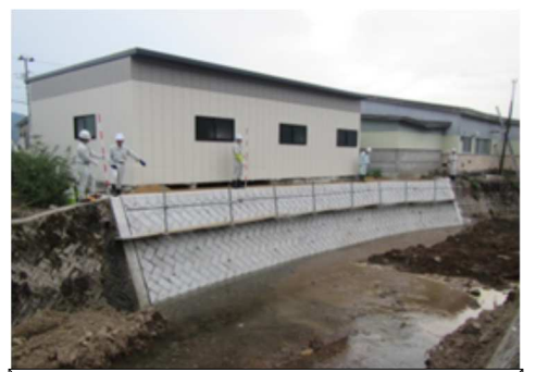
護岸崩壊による隣接倉庫の崩落を防止する本応急工事 生居川(上市市下生居)
