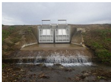
自動で開閉する構造のフラップゲート
