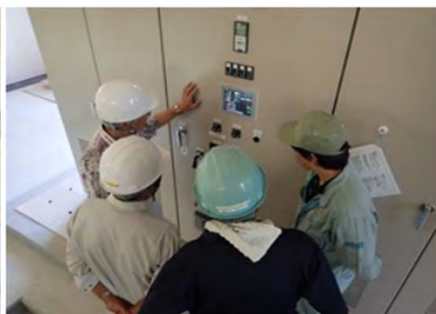
パネルで発電状況を確認
