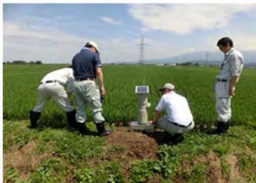
設置状況(排水側)
