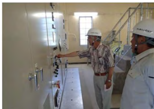
平津小水力発電所スイッチオン
