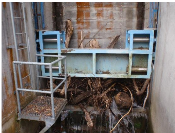
局地的な大雨による取水障害 (朝日川第二発電所 猿渡取水口)
