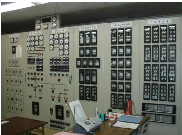
大沢川発電所（配電盤）
