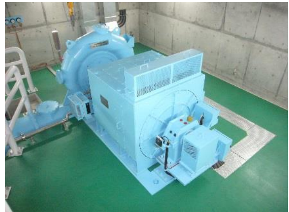
神室発電所 (H29. 10 運転開始)
