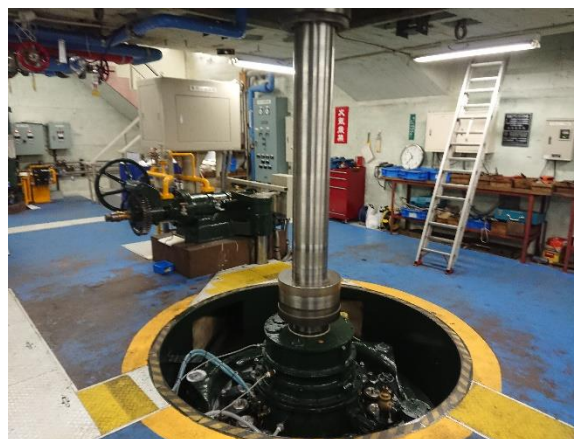
朝日川第二発電所（水車室）
