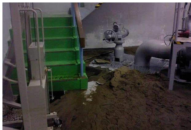
東日本大震災被災（酒田工業用水道）
