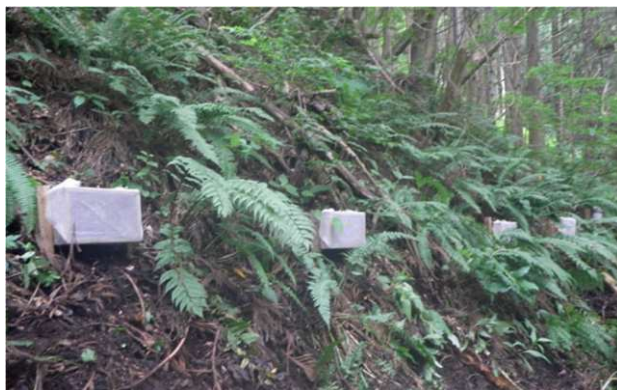
図 土砂受け箱設置状況写真
