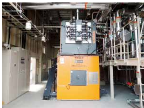
【バイオマスボイラー（最上総合支庁）】
