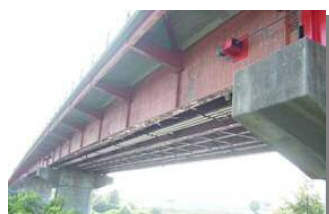
塗膜劣化による錆→放置すると腐食
